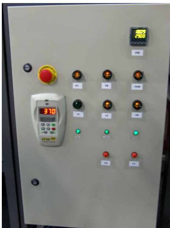
Figura 3.23 – Painele de Controle.
